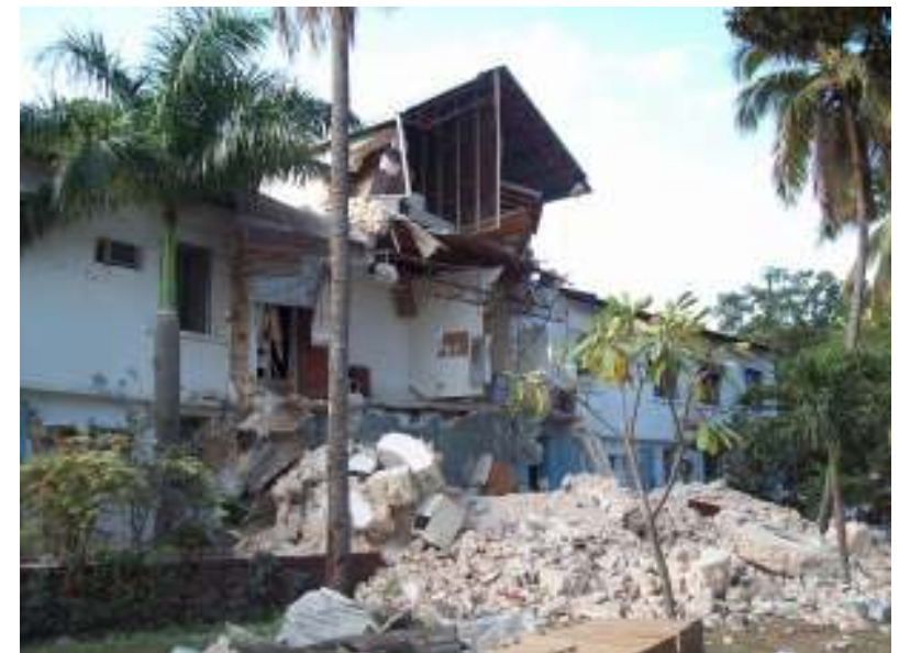
Le bâtiment principal de l'UEBH et du STEP détruit
